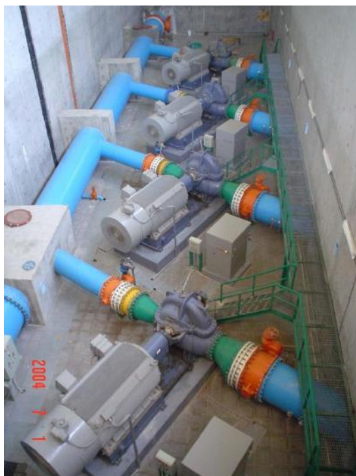
تصویر شماره ۹- ایستگاه پمپاژ- منبع: شرکت آب منطقه‌ای یزد
